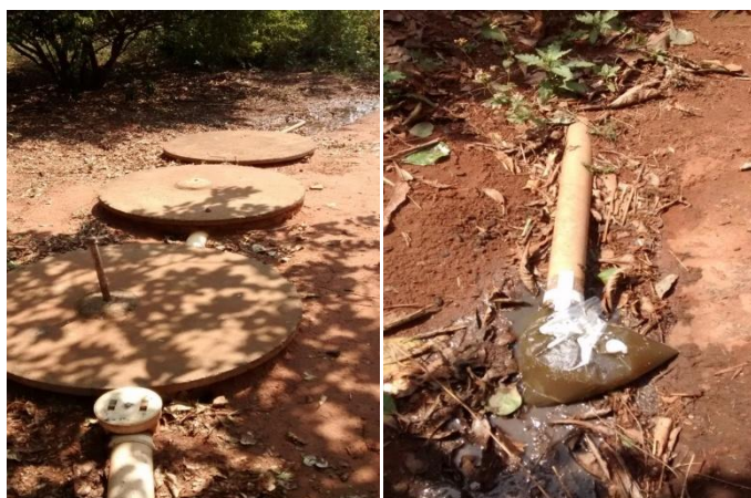
Figura 3: Fossa séptica biodigestora
